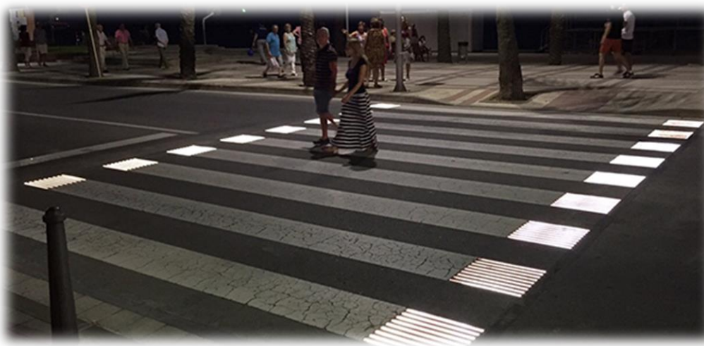
Figura 21. Paso de peatones dotado de iluminación led.
